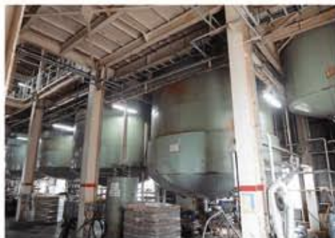
社員が快適に作業に取り組むため会社と工場の福利厚生も手厚く対応している(写真は50ト反応釜設備)
