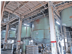
福井本社工場内にある大型の反応釜設備
