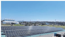
新たに整備導入した太陽光発電パネル
